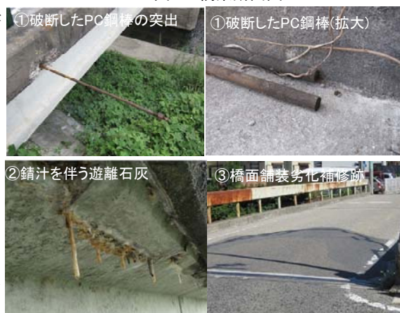
写真-1 既設PC橋の損傷状況
