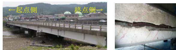
写真 1 橋梁状況及び PC 桁の劣化状況
