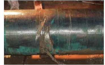
写真-1 CFS の破断 (高強度 RC 杭体)
