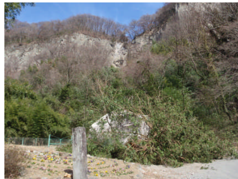
写真6 地震により対策箇所の一連の急崖斜面から発生した落石
