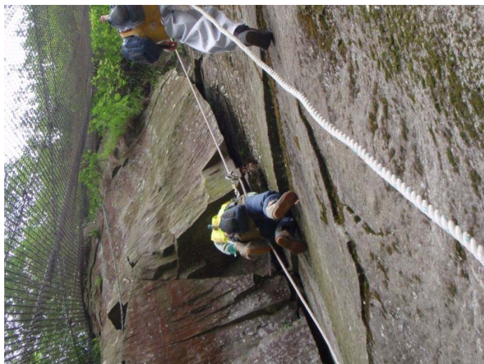
写真3 規模の大きい浮石の状況
