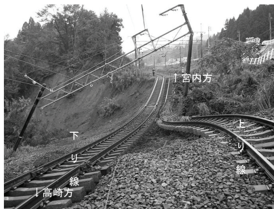
写真1 上越線における盛土の崩壊
