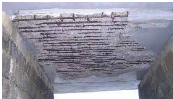
写真-2 桁の変状状況(線路左側より)
