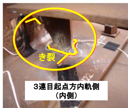
図4 疲労き裂の発生状況
