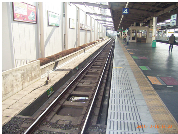
写真-1 劣化したスラブ軌道
