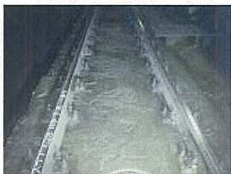
写真-1 変状したスラブ
