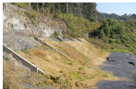
写真－1 表土流出とガリ浸食
