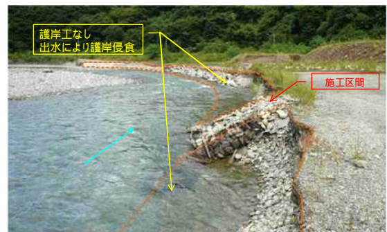
写真-5 施工後 1 年 1 ヶ月 出水後侵食状況
