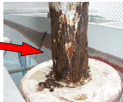
写真-1 定着部腐食状況
