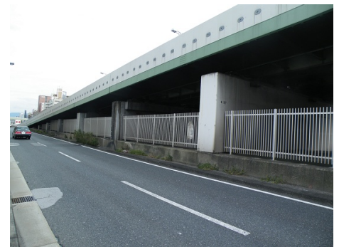
写真-1 損傷発生径間
