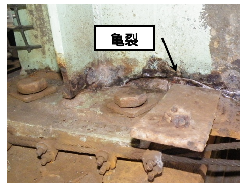
写真-2 主桁ウェブき裂状況
