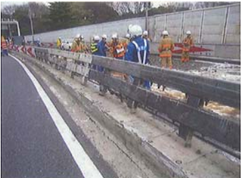
写真-1 事故状況
