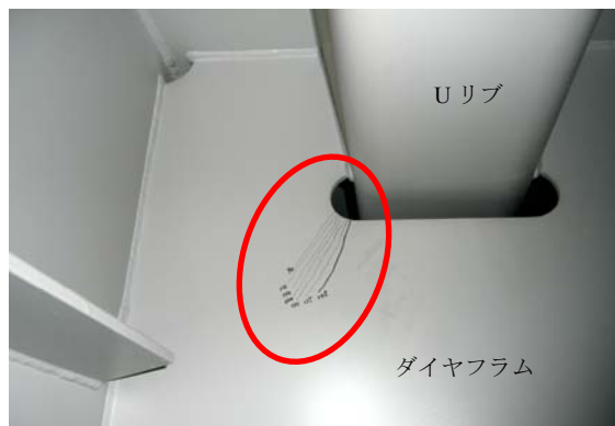
図-1 放射状塗膜割れ
