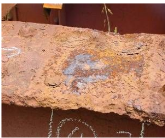
図.2 まくらぎ下のフランジの腐食
