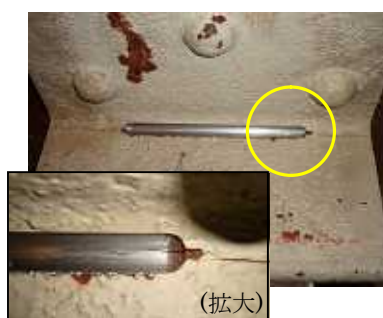
図6 疲労き裂発生状況 (Case 3)
