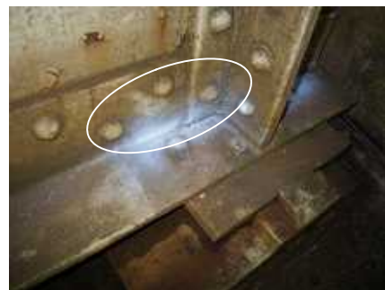
写真1 下フランジ山形鋼の疲労き裂
