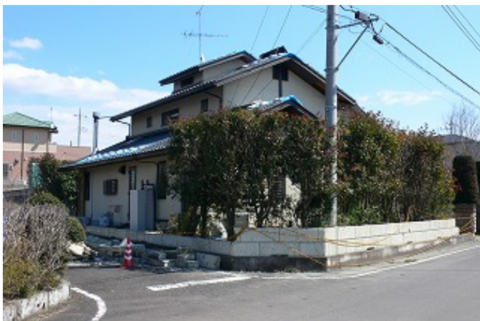
写真1 屋根瓦, 大谷石の塀の被害
