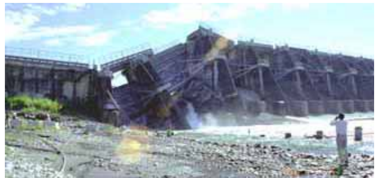
図-4 集集地震により破損した石岡ダム
