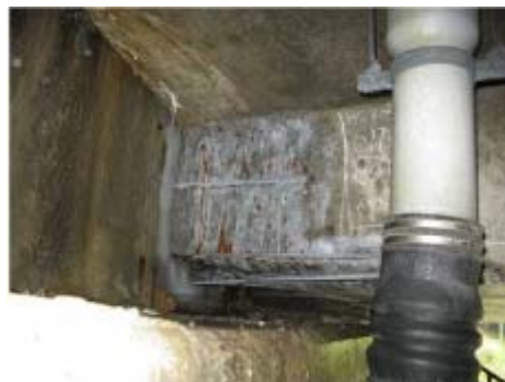
図2 コンクリート桁端の塩害
