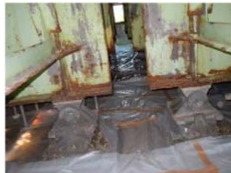
図1 鋼桁端の腐食
