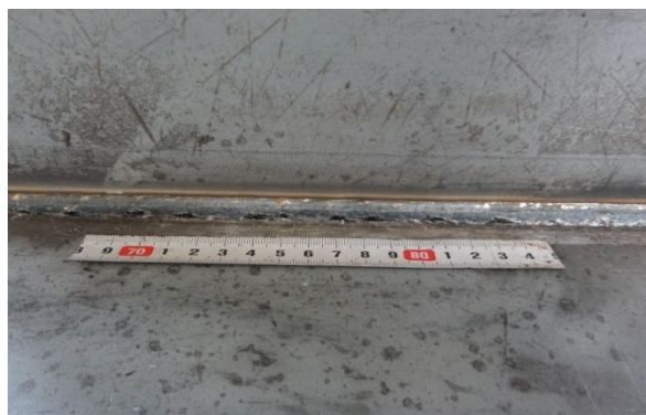
写真-3 溶接ビード外観
