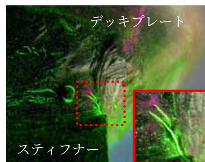
写真 1 疲労き裂の観察例
