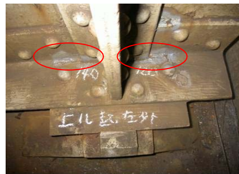
写真 1 下フランジ 山形鋼 コーナ部のき裂
