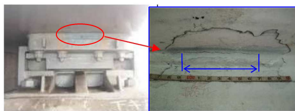
写真－1 ソールプレート溶接部のき裂
