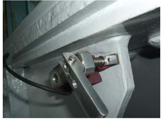
図-3 応力聴診器設置状況
