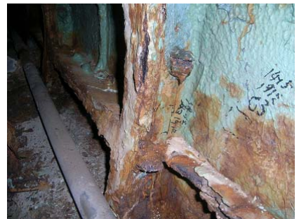
写真-1 劣化事象 1
