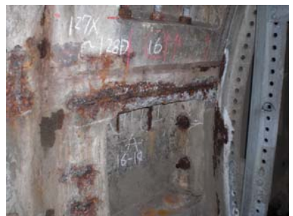
写真-2 劣化事象 2
