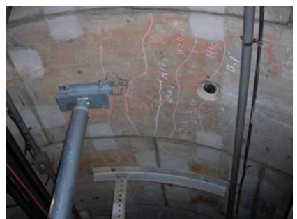
写真-3 劣化事象 4
