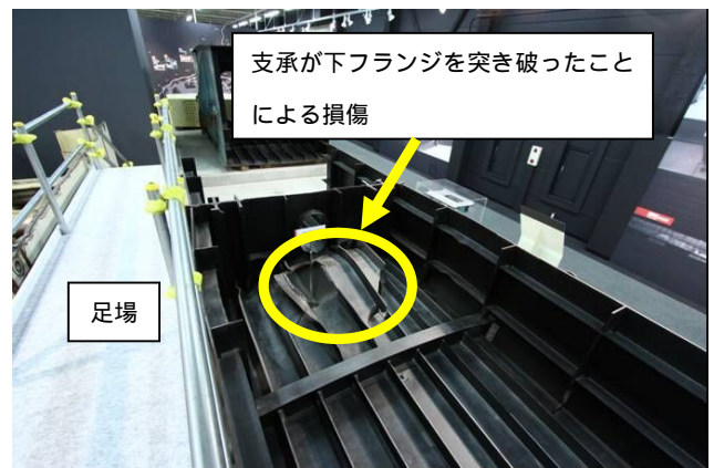
図-4 足場から見た被災構造物 (鋼製箱桁下フランジ損傷)
