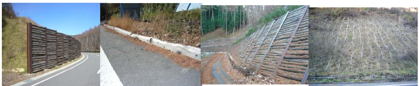
(a)落石防護柵 (b)路肩 (c)のり面保護工 (d)のり柵工 写真-2 乾燥を必要とせず CO 2 排出量の少ないと考えられる木製構造物
