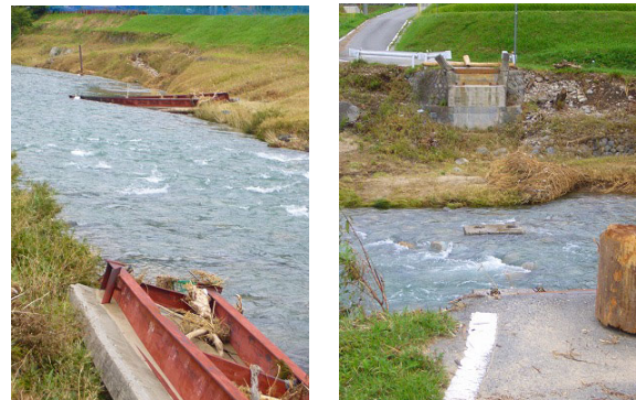
写真1 兵庫県佐用郡・宍粟市 H21.8.9 豪雨による流橋被害事例 1)
