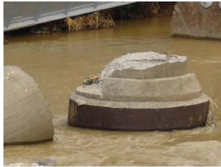
図-3 福井水害において折損した橋脚
