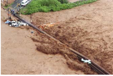
図-2 福井水害において洪水に水没する橋桁
