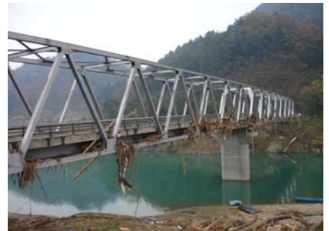
図-7 宮崎水害において桁に流水・流木が作用したが耐えた新トラス橋
