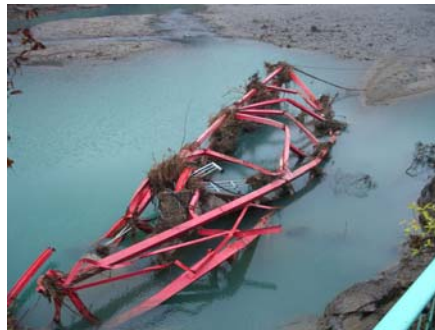
図-6 宮崎水害において支点ボルトが折損した新耐震設計指針前トラス橋
