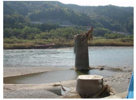
図-4 宮崎水害において打ち継ぎ目が剥れた橋脚
