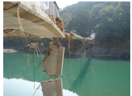
図-10 宮崎水害において損傷した吊り橋
