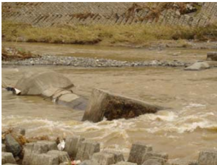
図-5 福井水害において岩着部が剥れた橋脚
