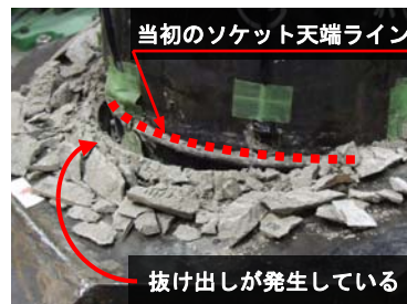
図-5 試験体 T-7 5δy 損傷状況 (埋め込み長 1.5D, 定着長 33φ)
