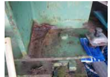
図-1 けた端部の腐食状況
