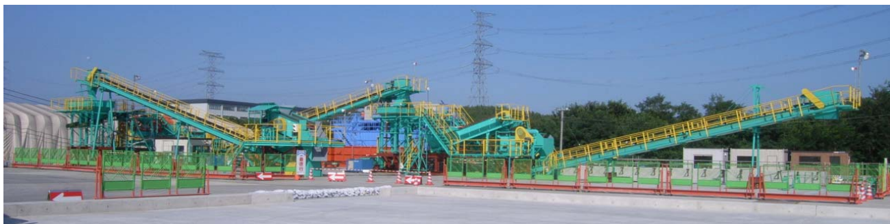
写真-1 洗浄システム（プラント）全景
