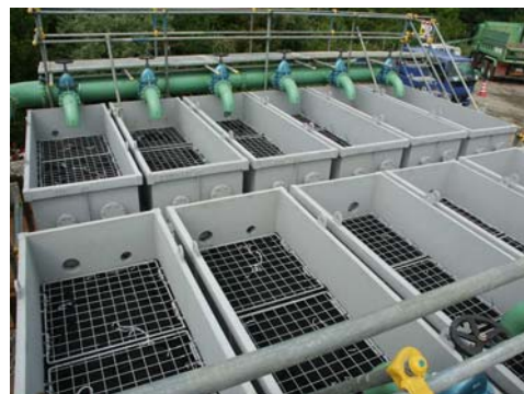
写真-2 活性炭吸着槽設置状況
