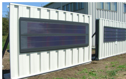
図2 壁ソーラーパネル
