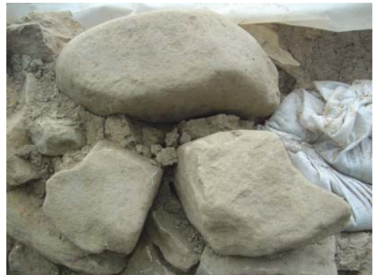
写真-2 崩壊しそうな石垣
