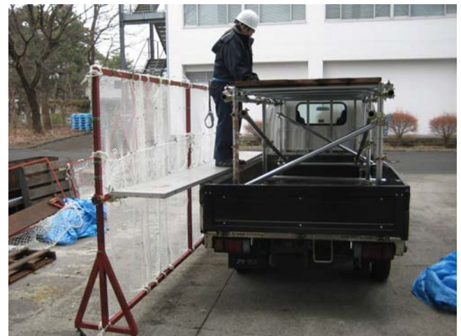
写真5 作業床による荷主庭先据置型の墜落防止設備
