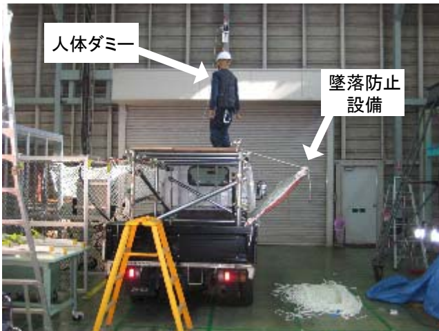
写真2 安全ネットによるトラック積載型の墜落防止設備
