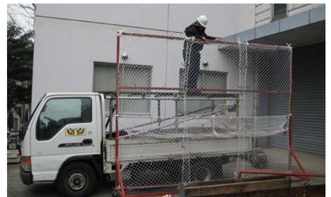
写真6 柵による荷主庭先据置型の墜落防止設備
