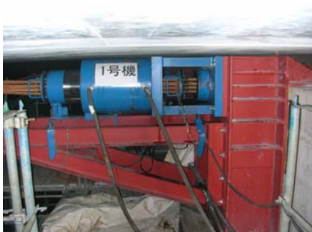
写真-2 押し出しジャッキ
