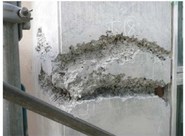
図3 大きなジャンカのあったコンクリート柱
