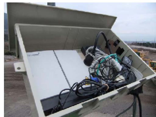
写真-2 衛星通信アンテナ
