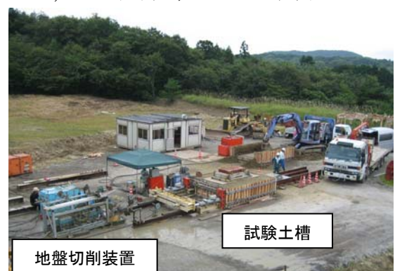
写真-2 試験設備全景
