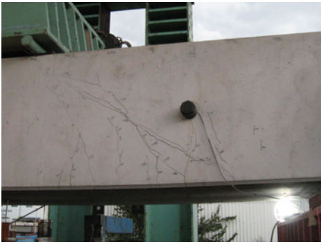
写真-2 せん断ひびわれ発生状況
