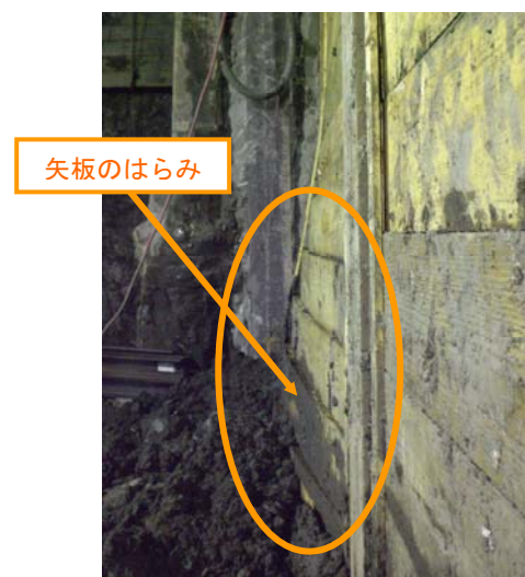
写真-1 切羽土留矢板のはらみ状況
