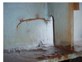
写真-1 き裂状況
