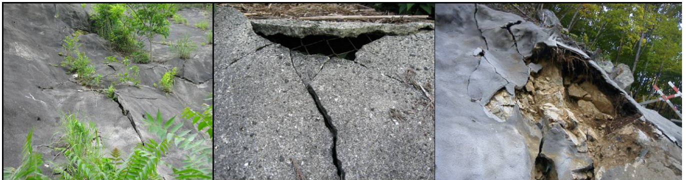
はらみ出しによるモルタルの亀裂
