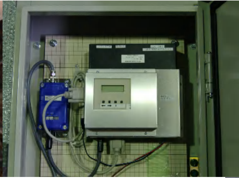
図-2 受信装置・コントロールボックス
