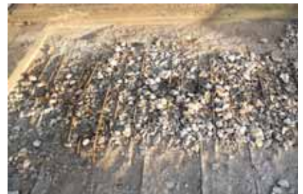
写真1：床版上面損傷例
