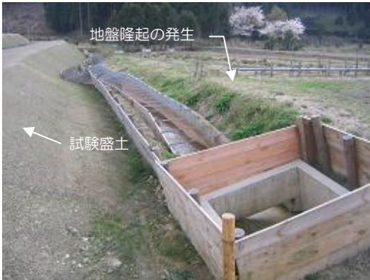
写真-1 試験盛土法尻付近の変形状況
