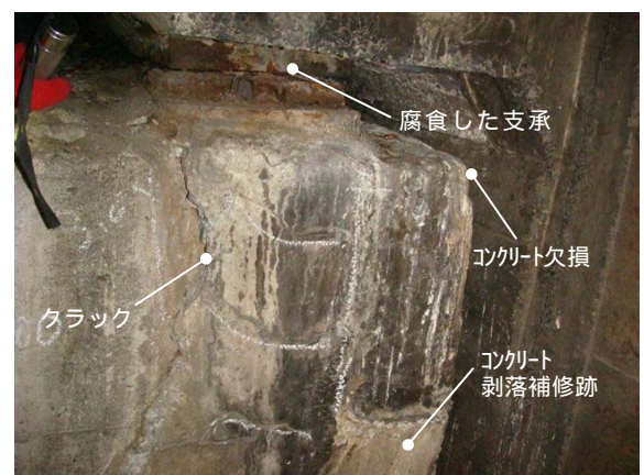
写真-2 ゲルバー部損傷状況
