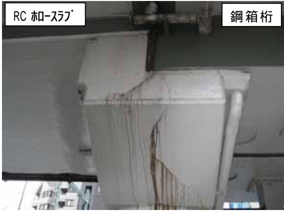
写真-1 橋脚横梁クラック発生状況
